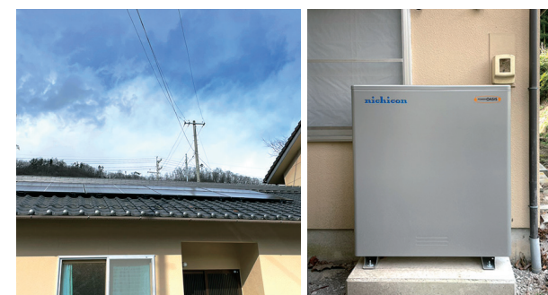
太陽光パネルと蓄電池の写真
